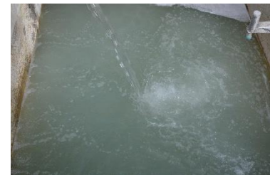
Depuradora. Aigua tractada
