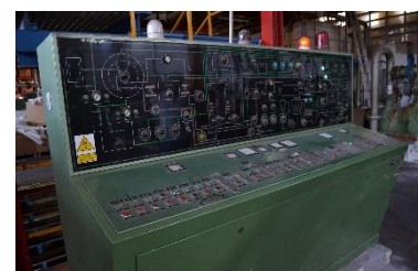
Comandament de la màquina Voith.
