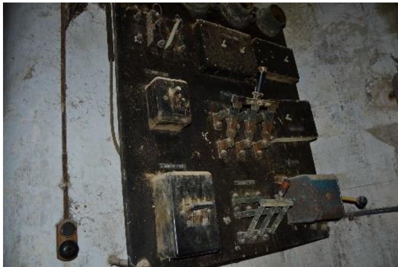
Quadre elèctric de la màquina antiga 150
